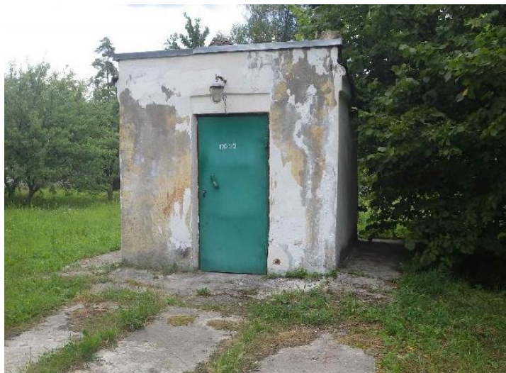
Рисунок 20. Надземный павильон скважины № 22
