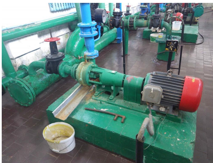
Рисунок 16. Насосное оборудование станции второго подъема
