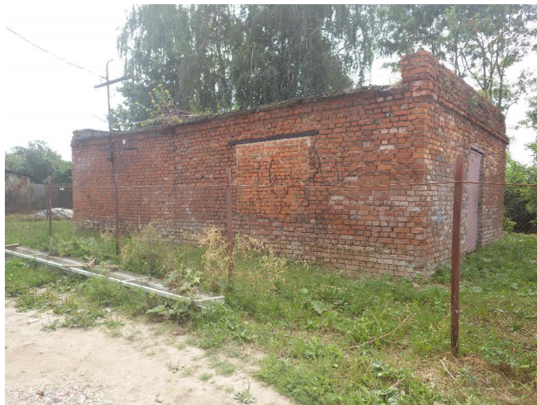
Рисунок 27. Надземный павильон скважины № 50
