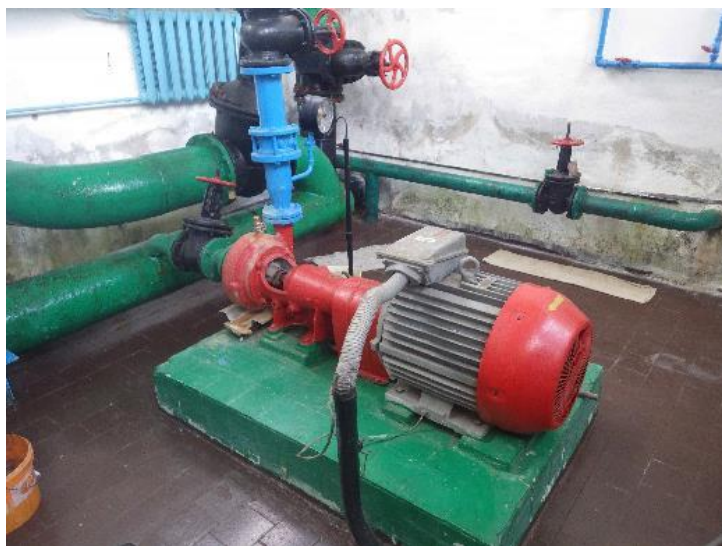
Рисунок 15. Насосное оборудование станции второго подъема
